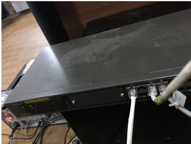
Gambar 3.21 Kabel LAN Yang Dihubungkan Ke Switch
