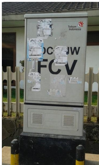
Gambar 3.1 Optical Distribution Cabinet (ODC)
