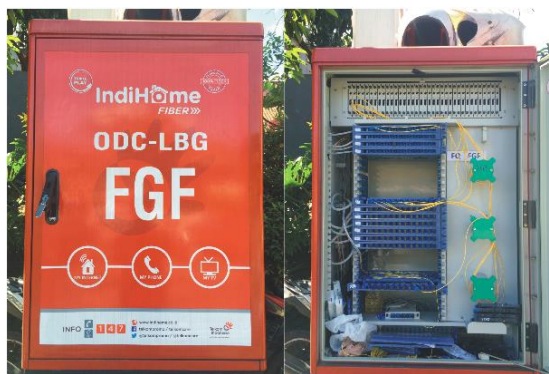
Gambar 19 - Kondisi ODC-FGF dengan kondisi baik
