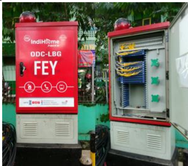
Gambar 15 - ODC-FEY dalam kondisi baik.
