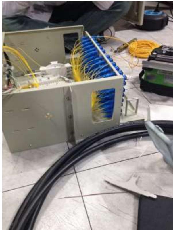
Gambar 3.15 Peningstalan Tieline di ruang transmisi
