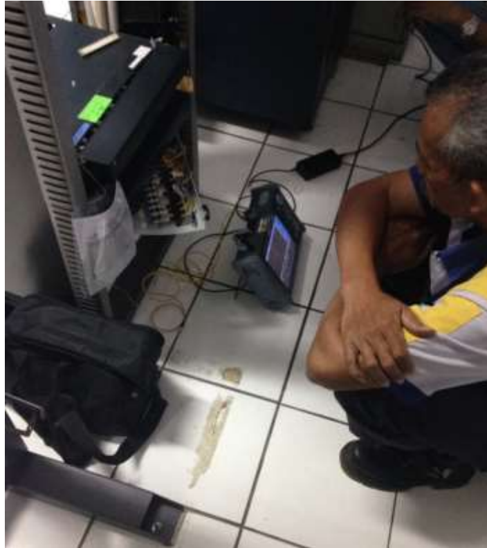
Gambar 3.2 Penggunaan OTDR untuk mengetahui lokasi kerusakan kabel
