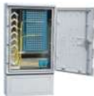
Gambar 3.11 Outdoor Distribution Cabinet (ODC)
